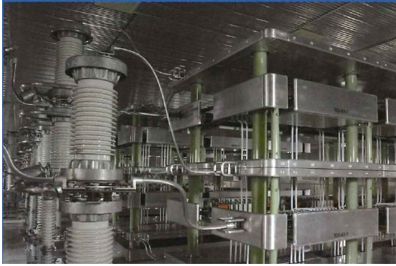
Hình 16. Van thyristor trong trạm Shin-Shinano 300 MW (kiểu LCC)
