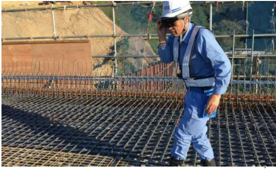
Hình 7. Kỹ sư đang sử dụng kính HoloLens để kiểm tra độ chính xác của việc đặt cốt thép (hình ảnh tham khảo từ tài liệu giới thiệu sản phẩm của công ty Informatix Inc.)
